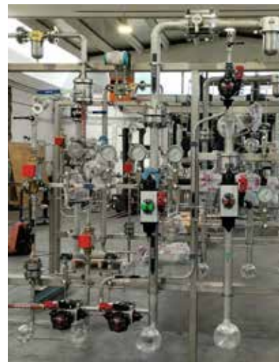
APPARECCHIATURE PER IL CONTROLLO DEL GAS
